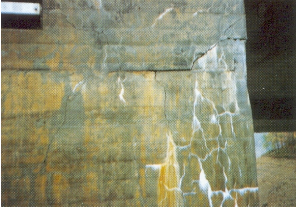
Figura 3.8 – Barragem de Fontana (USA) – Vista do vertedouro, Fissuração e deslocamento, ANDRADE et al (1997).
