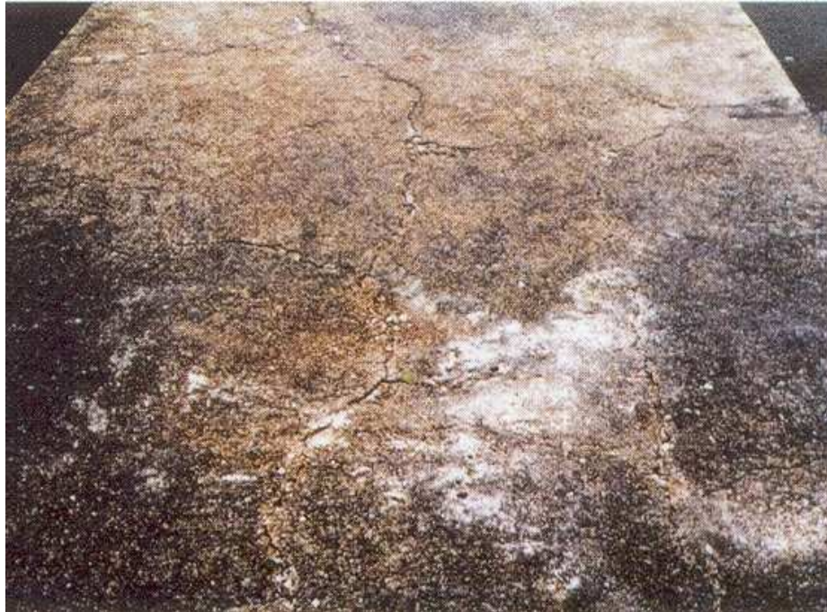
Figura 3.6 - Barragem de Mascarenhas de Moraes – Detalhe de fissuras tipo mapa na crista de um muro divisório da calha, ANDRADE et al (1997).
