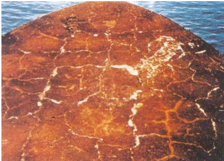
Figura 3.7 - Barragem de Porto Colômbia – Detalhe do topo de um dos pilares do vertedouro com fissuração tipo mapa e deslocamento nas bordas, ANDRADE et al (1997).
